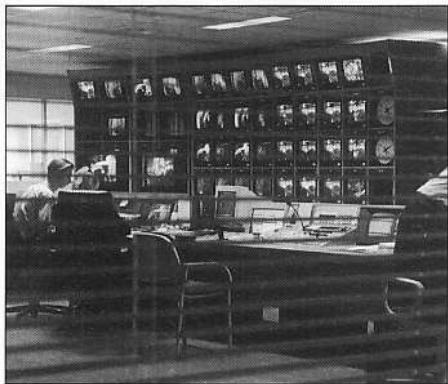
Het Nethold monitoring centrum in Hoofddorp.
